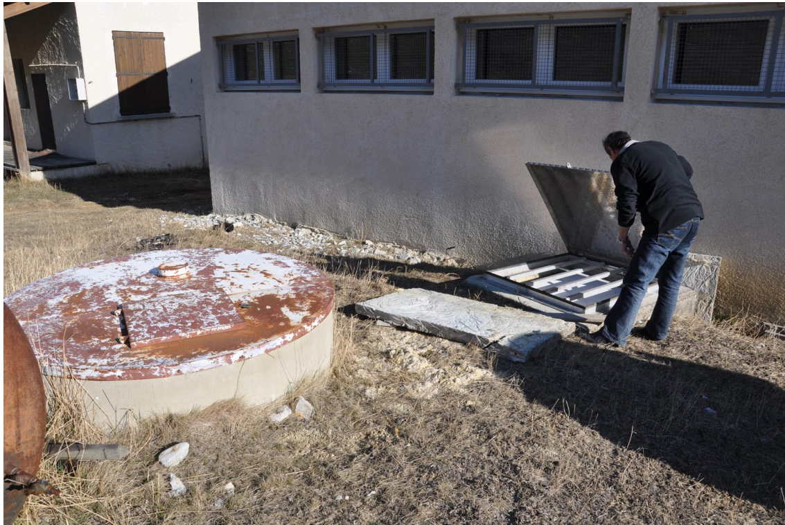
Dispositif de traitement de l'eau avant alimentation du bâtiment d'accueil . Photo M. Douarche atm
