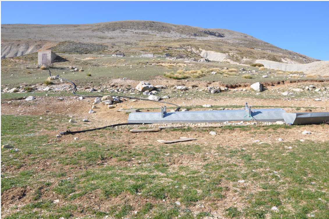
Captage en adret, en amont des bâtiments d'accueil, et abreuvoir, zone de paccage. Photo M. Douarche atm
